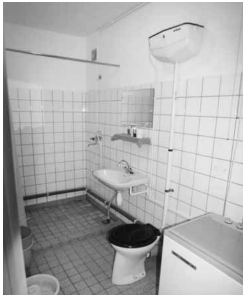
Badkamer in huurflat vóór renovatie in '95, waarbij o.a. stortbak van w.c. wordt vervangen door duoblok
